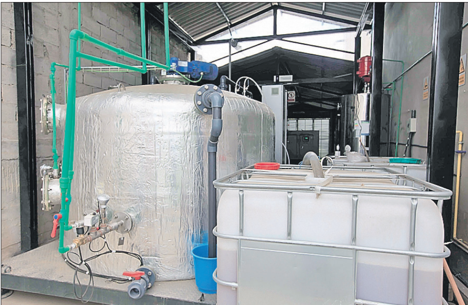
Este es un reactor de digestión anaerobia (sin oxígeno) para obtener metano y de allí energía eléctrica. / XCA
